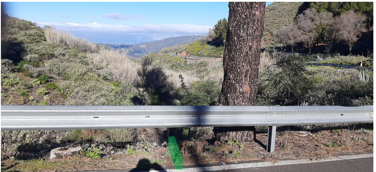
GC-21 (salida pasatubo en calzada) con salida a zona de barranquillo.
