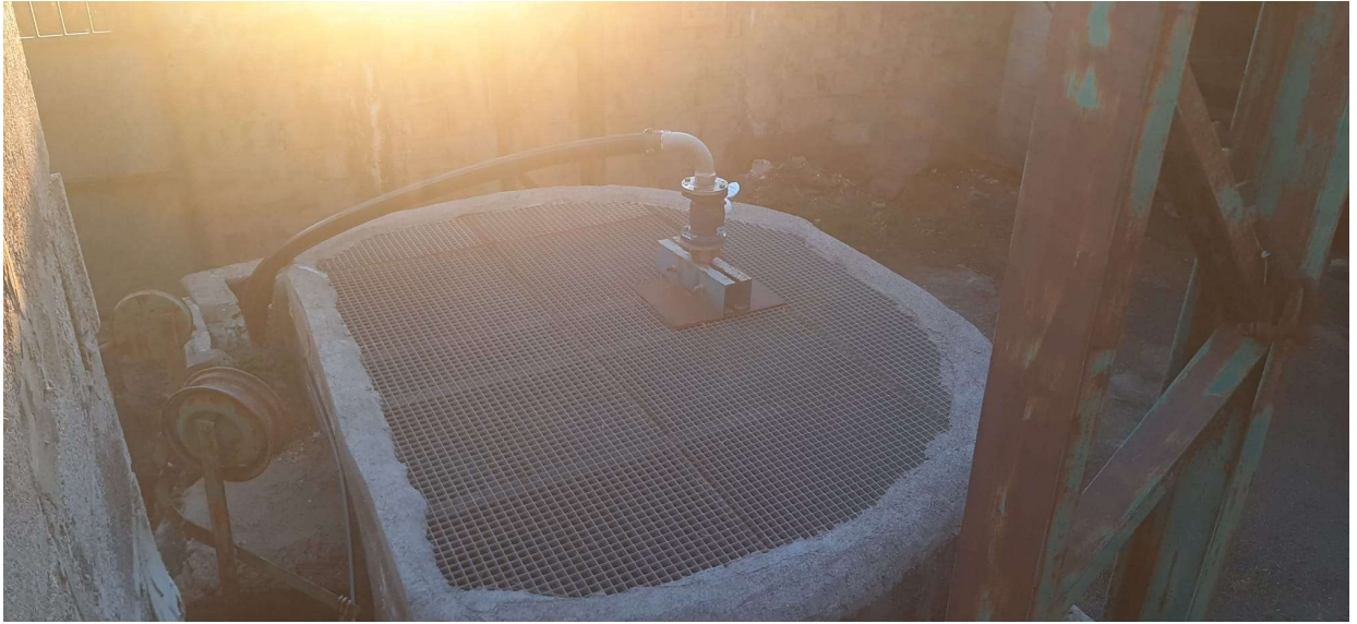
Detalle salida pozo con conexión a contador actual.
