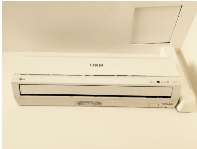
Imagen 4. Vista equipos climatización actuales
