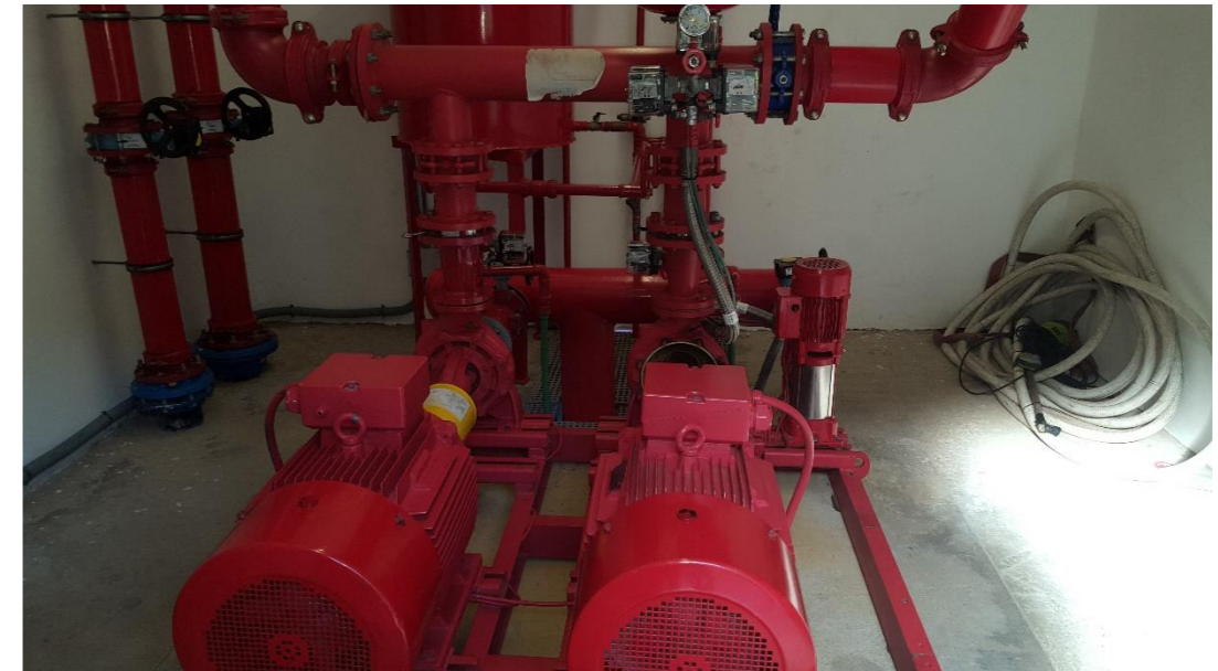
Imagen 5-4.-Bombas instaladas en el Centro de Bombeo
