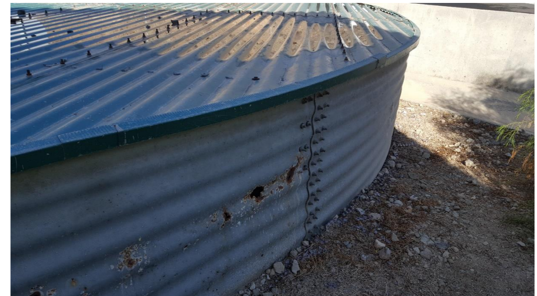
Imagen 5-2.-Depósito de aguas
