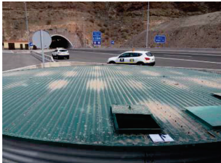
Figura 7: Estado actual del exterior del depósito – Consecuencias de la corrosión avanzada del interior.
