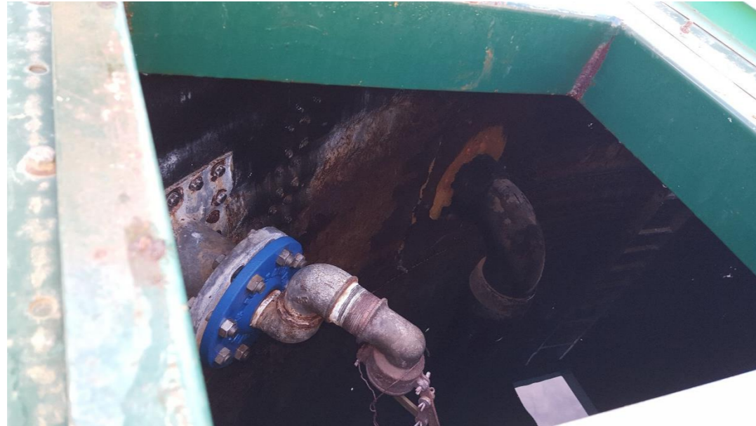
Imagen 5-3.-Tuberías interiores del depósito
