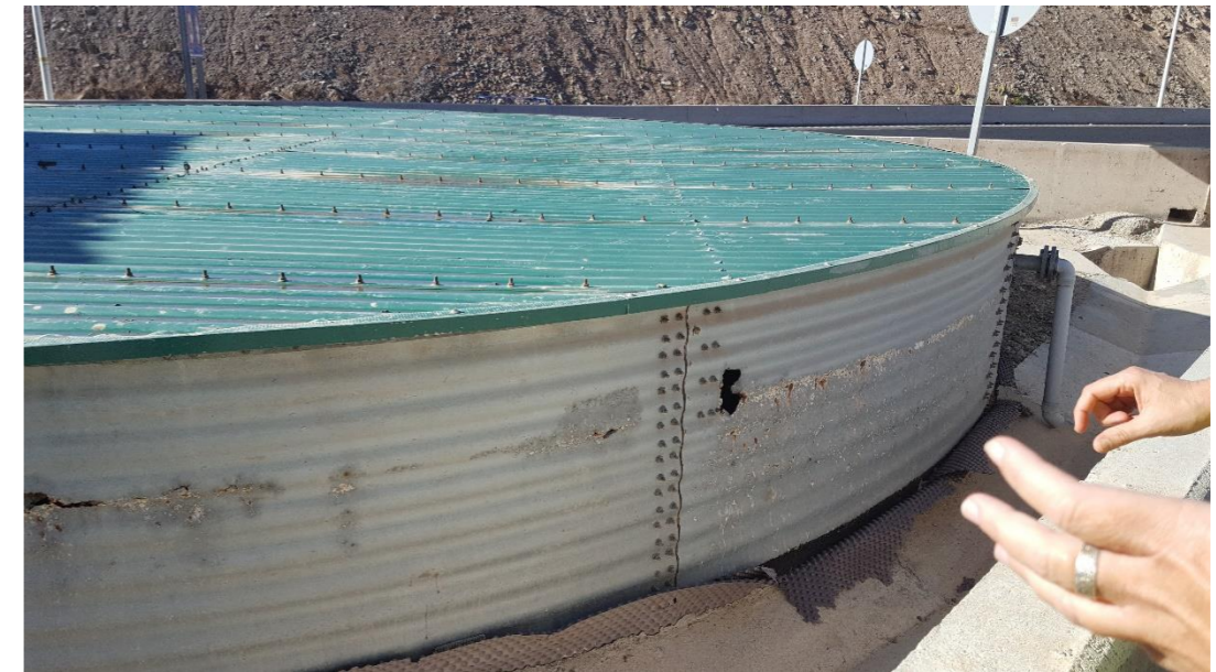
Imagen 5-1.-Depósito de aguas
