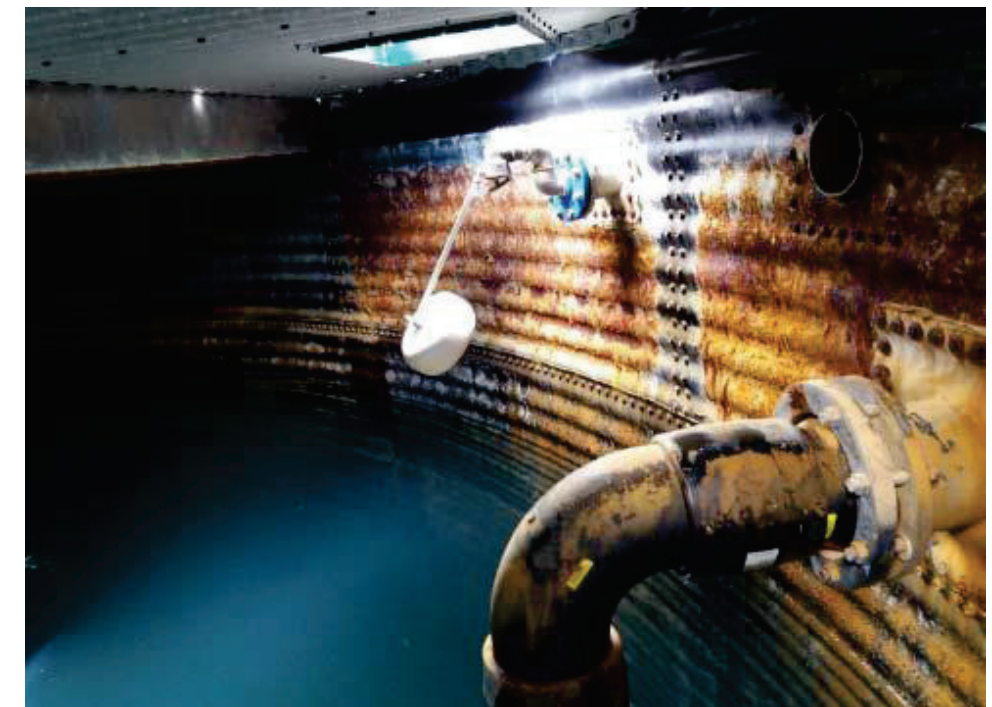
Figura 5: Estado actual del interior del depósito – Grado de corrosión avanzada.
