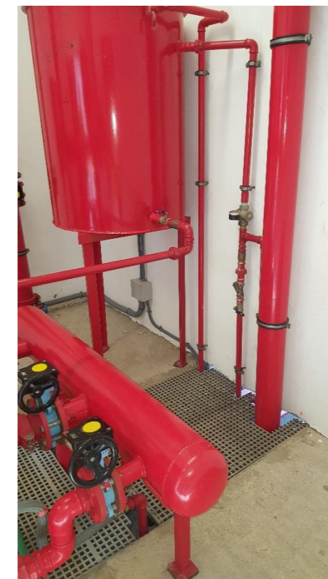
Imagen 5-5.-Entrada al equipo de bombeo
