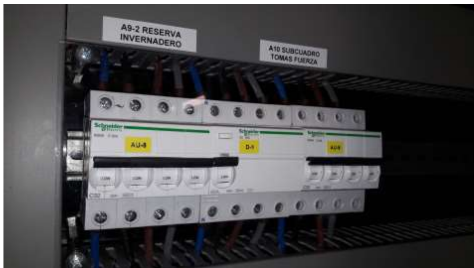
Cuadro existente en el cuarto de bombas
