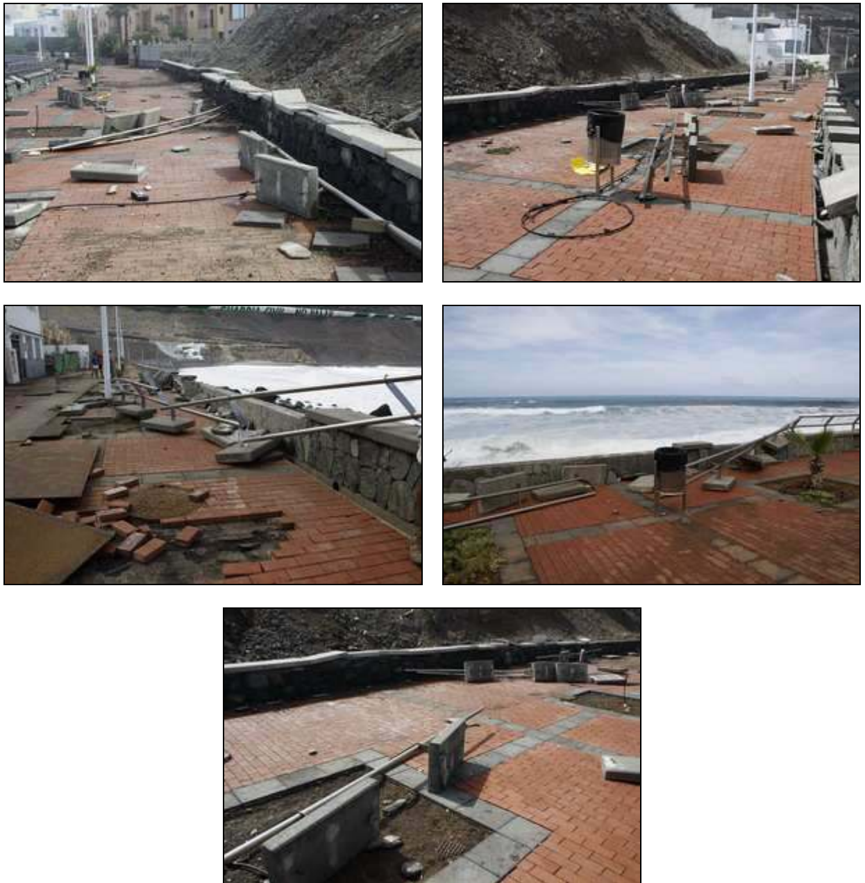
Figura 7. Imágenes de los daños producidos en el paseo marítimo con motivo del temporal de oleaje de 10/10/2010.
