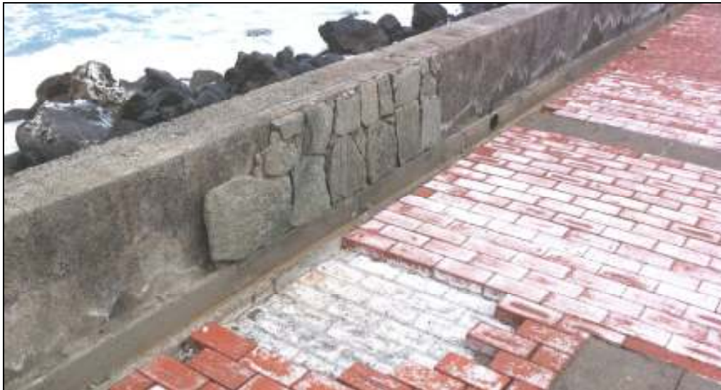
Figura 35. Imagen actual del estado del revestimiento del trasdós del murete del paseo
