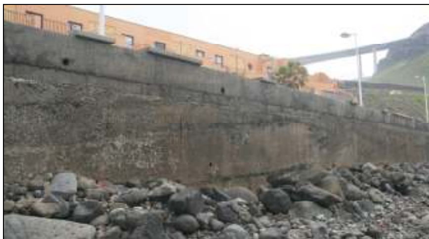
Figura 6. Imagen actual del paseo en uno de los tramos en los que el cimientado del muro ha quedado visible
