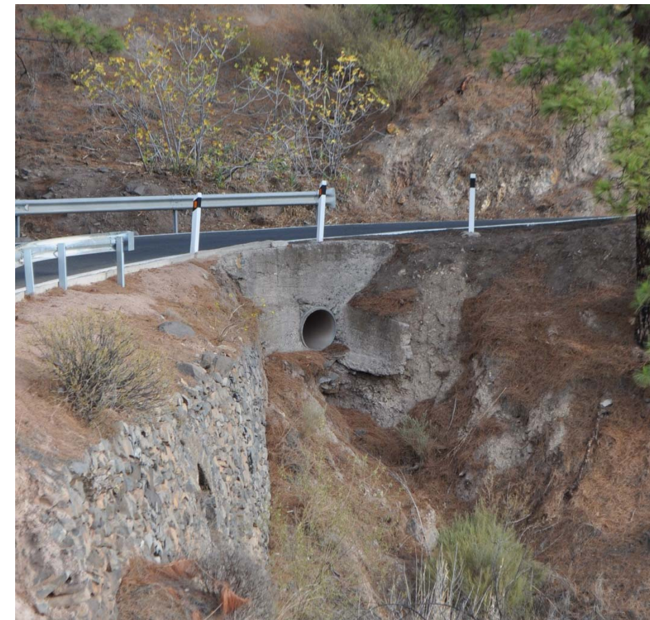
Ilustración 4. Obra de Drenaje Transversal existente en la curva.
