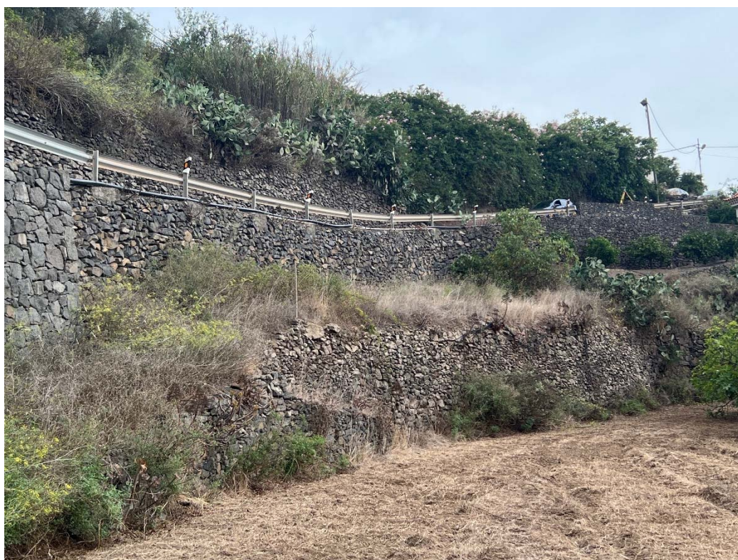
Figura 2. Muros existentes en mal estado. Fuente: Rabadán 17
