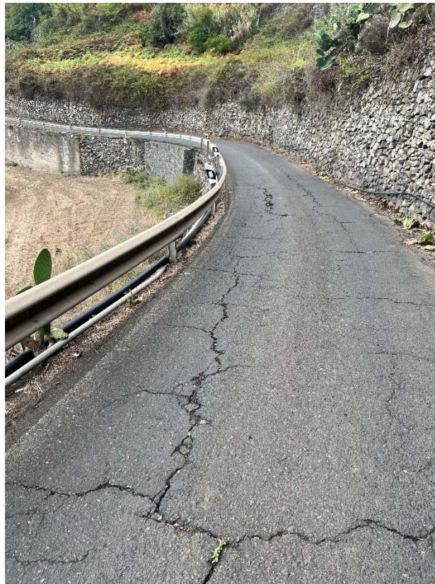
Figura 1. Grietas y blandones de la plataforma. Fuente: Rabadán 17
