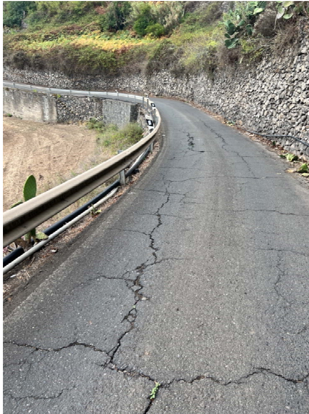
Figura 1. Estado del firme existente
