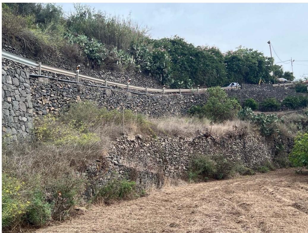
Figura 2. Muros existentes en mal estado. Fuente: Rabadán 17
