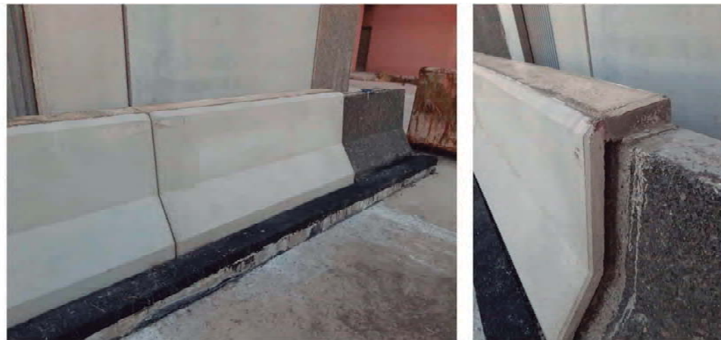
Detalle del incremento de altura conseguido y superficie de unión con el siguiente tramo
