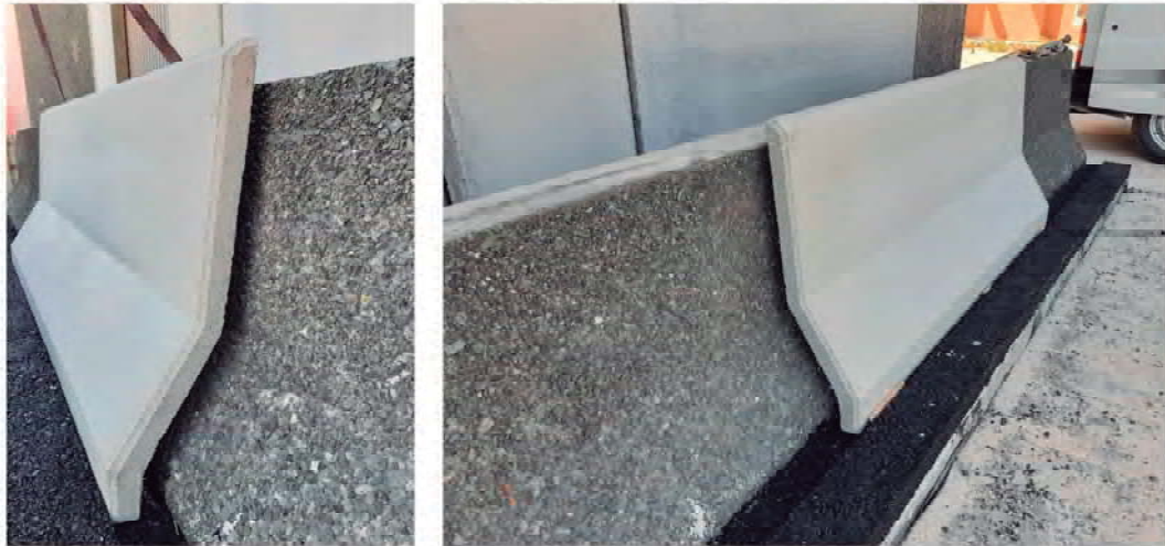
Colocación de una pieza mediante inserción en el cajeadado y apoyo en la barrera existente
