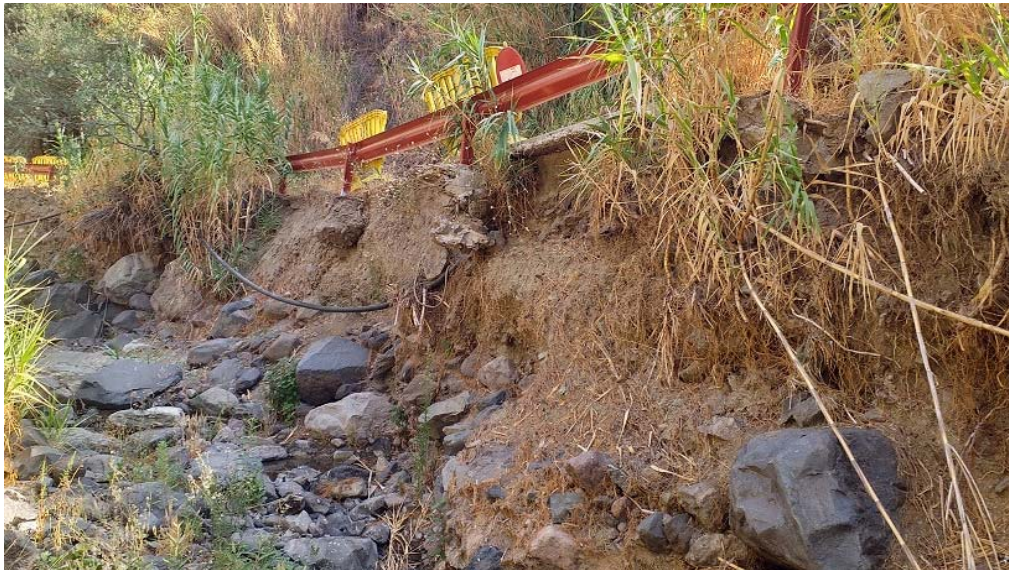
Foto 1: Socavamiento del borde del camino
