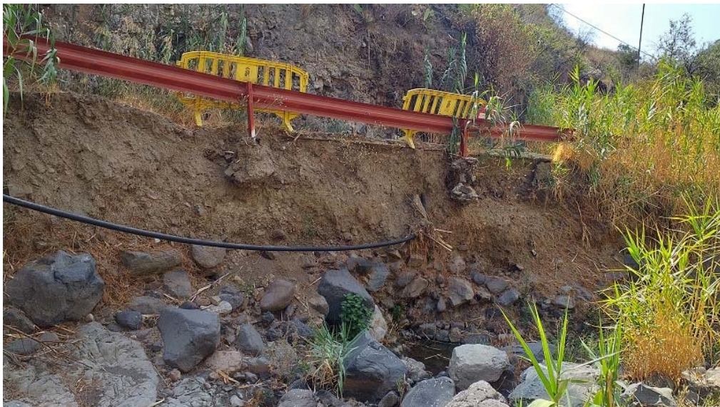
Foto 2: Socavamiento del borde del camino
