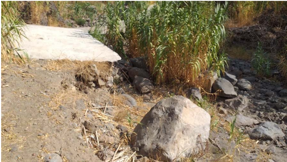
Foto 5: Vista aguas arriba del inicio de la pista afectada por las escorrentías.
