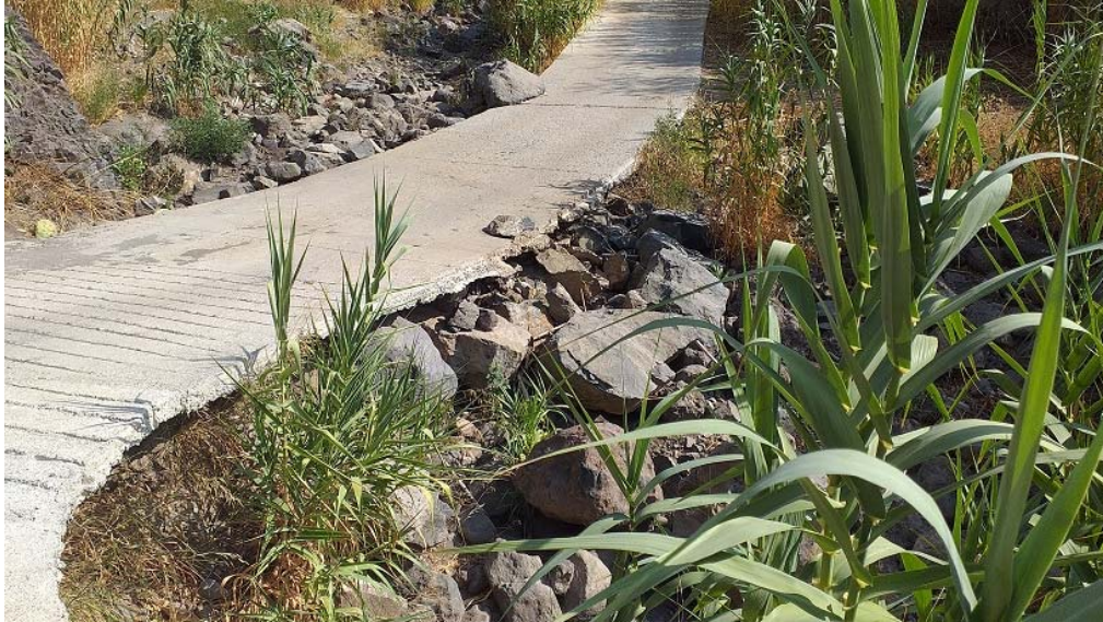
Foto 3: Badén con socavamiento de la losa de hormigón.
