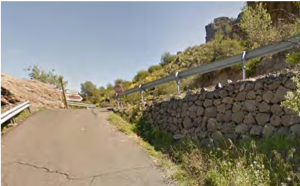
Foto. Muro de contención de la GC60 en el punto de cruce de la tubería.
