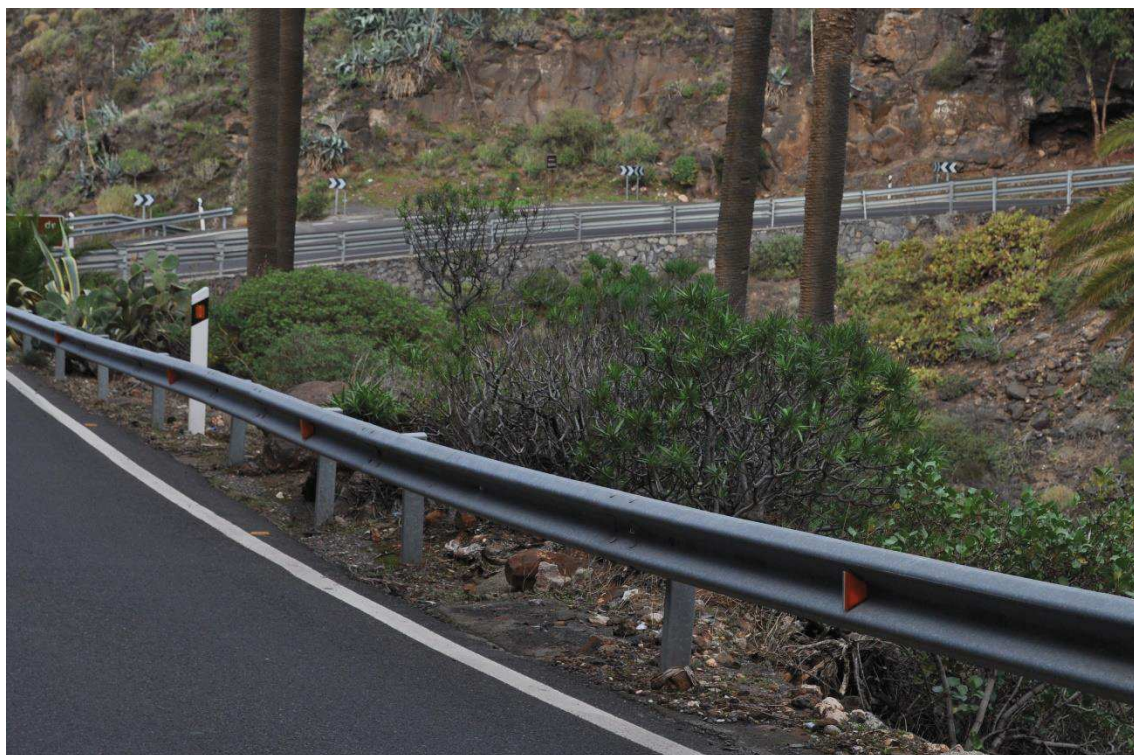
Ilustración 3. BMS existente a retirar y recolocar al finalizar las obras previstas.
