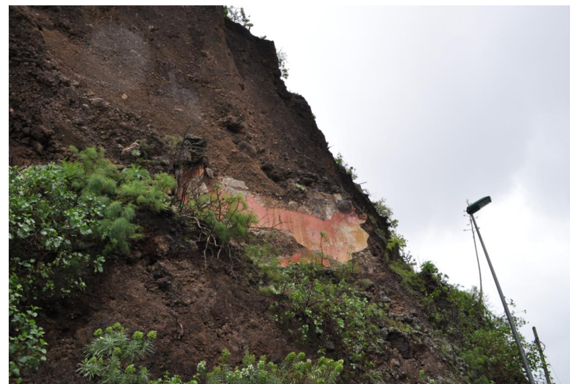
Ilustración 3: Restos de edificación en la parte alta del talud en la GC-321.
