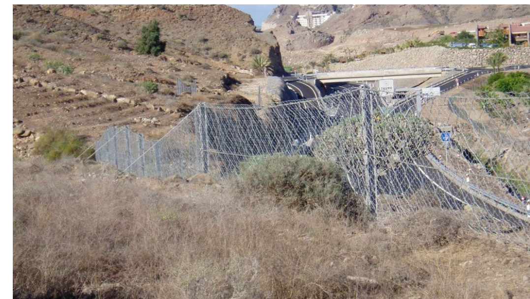
Imagen 3-2.-Instalación barrera estática
