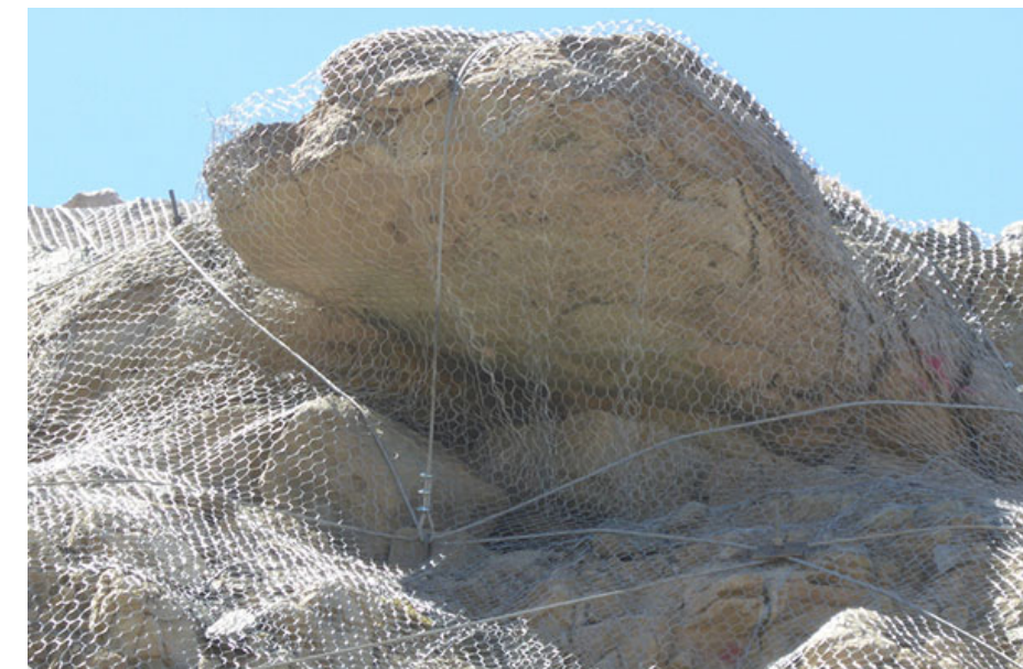
Imagen 4-2.-Red de cables
