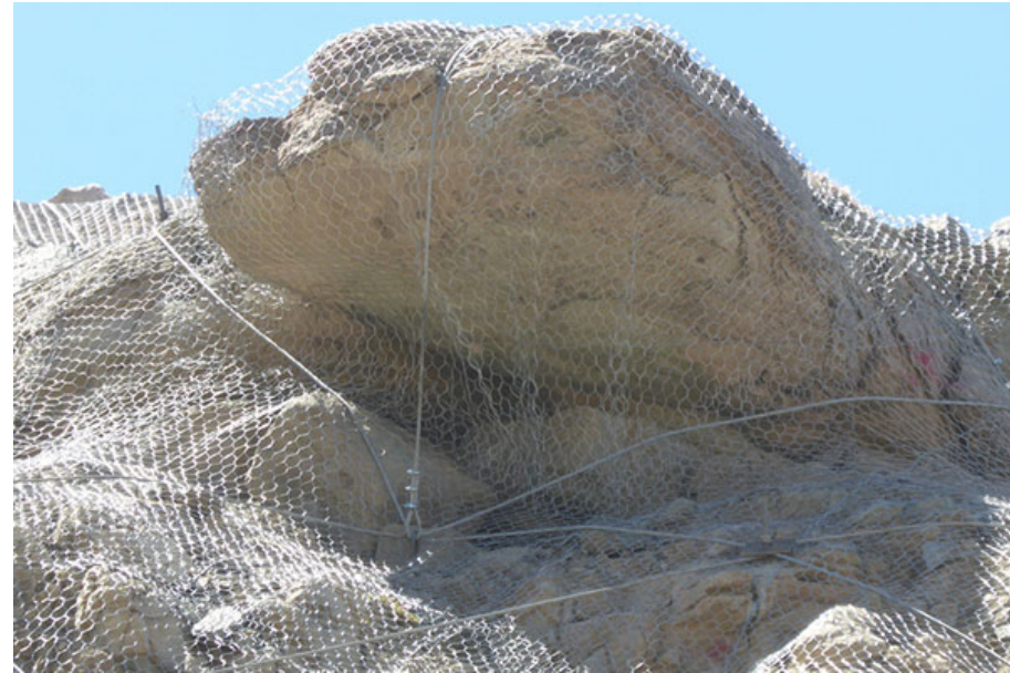
Imagen 3-3.-Red de cables
