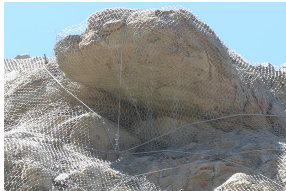
Imagen 3-2.-Red de cables
