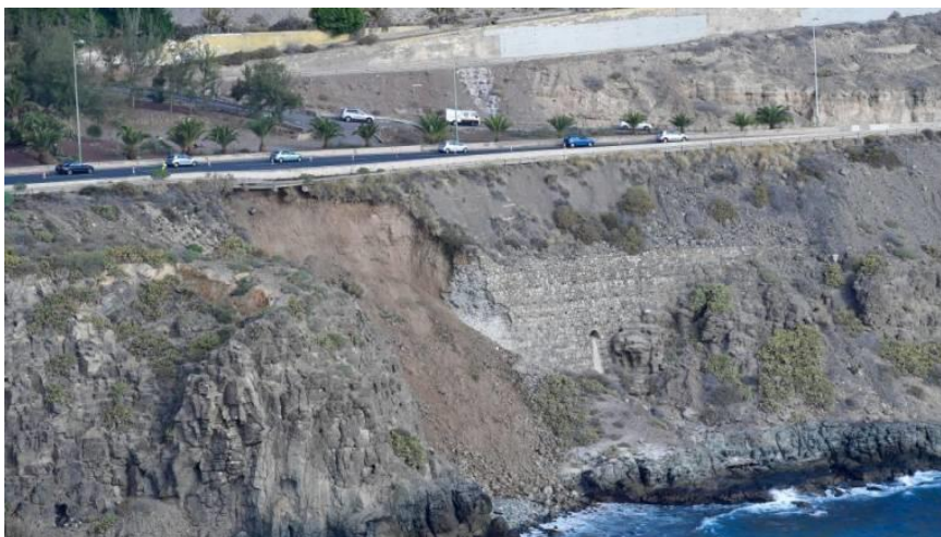
Colapso muro GC-1. Fuente: Desconocido
