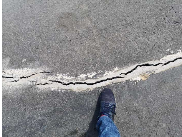
Grietas GC-1. Fuente: Rabadán 17
