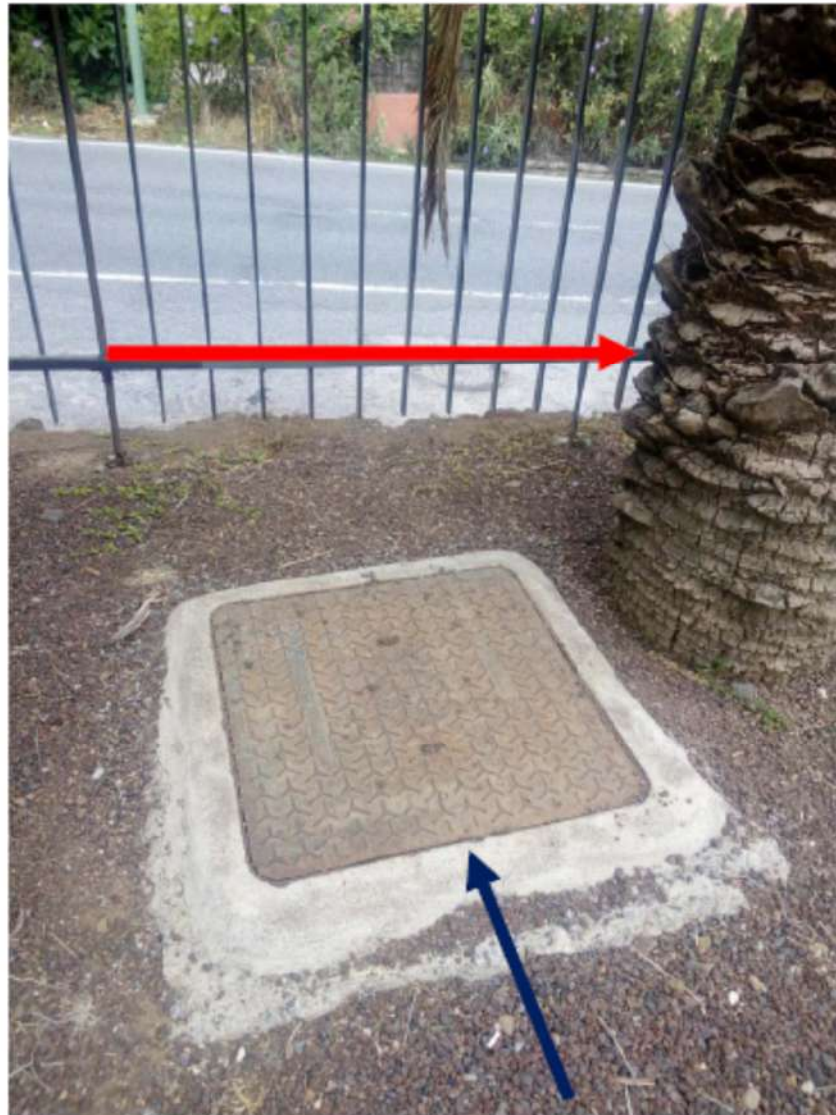
Arqueta de acometida a la Red general
