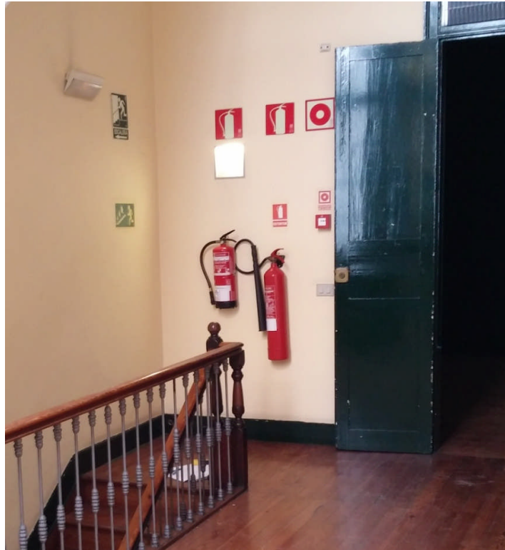
Imagen 5.- Vista ejemplo instalaciones PCI actuales
