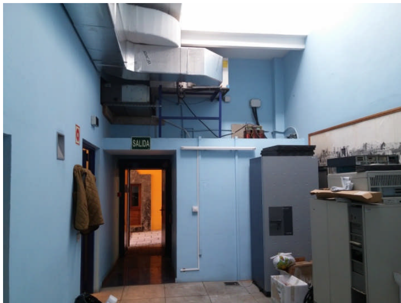
Imagen 4.- Vistas instalaciones actuales
