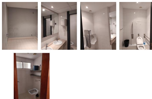
Estado actual: Planta 2ª – selección de fotografías de aseos y cuarto de limpieza.
