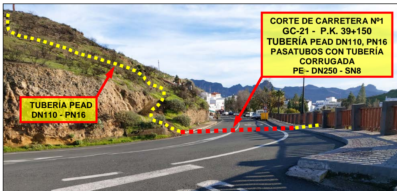
Fotografías nº 11 (panorámica de la ubicación del corte de carretera nº1, GC-21 - P.K. 39+150)
