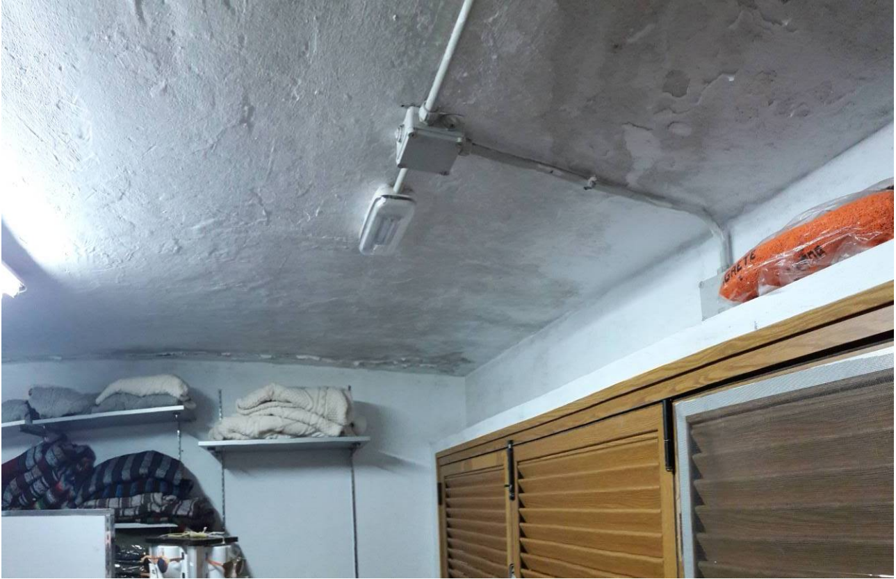
Vista general interior de los puestos. Humedades en Cubiertas
