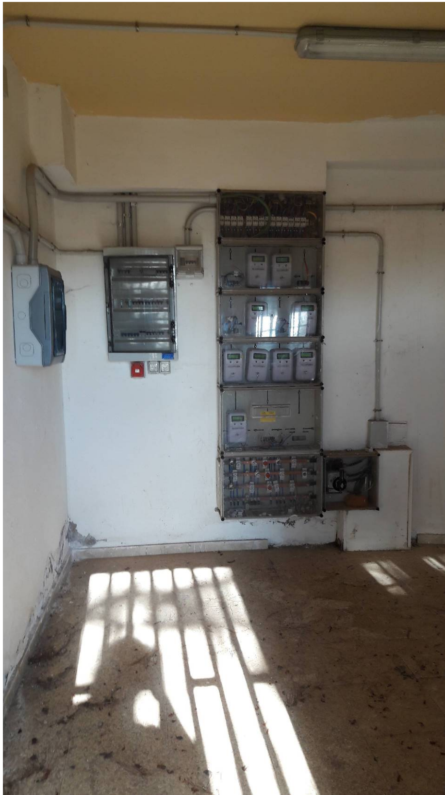
Vista general interior del cuarto de cuadros
