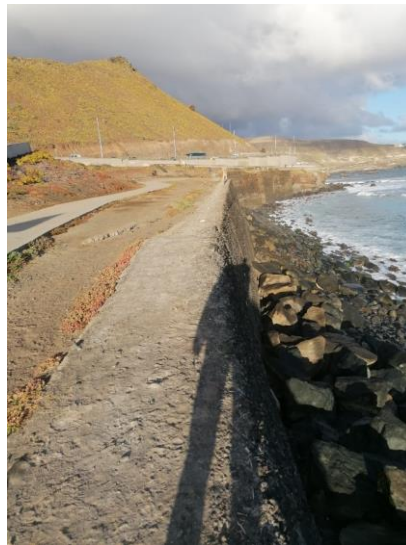
Ilustración 6 altura del muro sin protección
