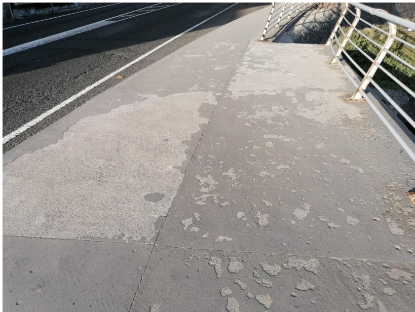
Ilustración 3. Deterioro del pavimento.
