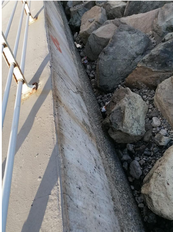
Ilustración 4 Desnivel del segundo tramo de barandilla.
