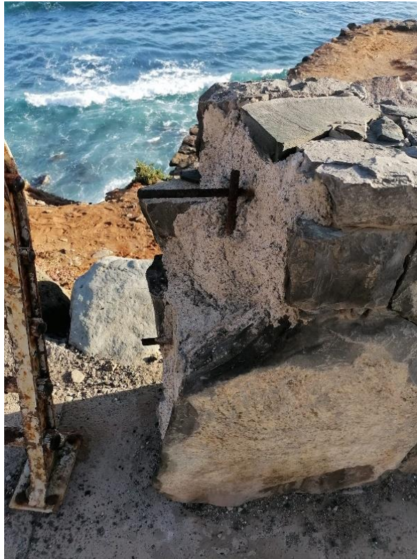
Ilustración 10 Pretil de mampostería en zona en PK 2+500 con armaduras oxidadas sin protección
