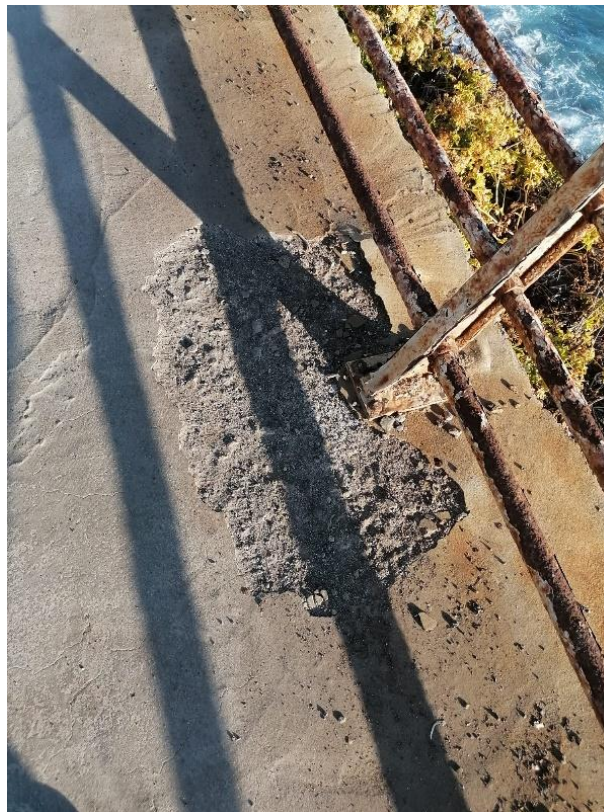
Ilustración 11 estado de oxidación de la barandilla
