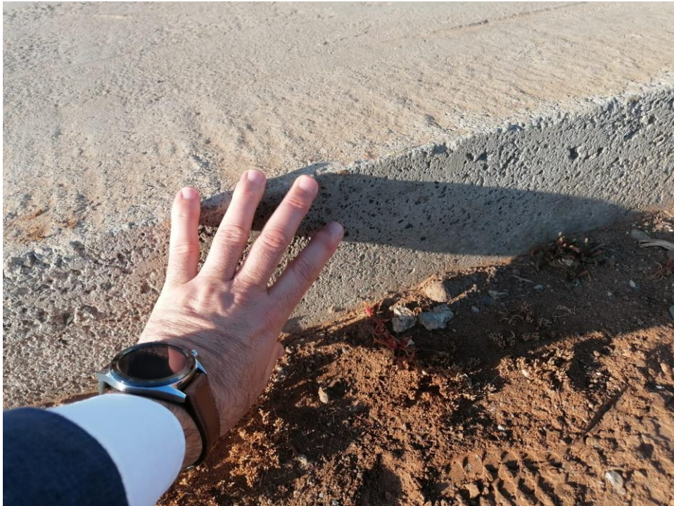
Ilustración 15 Espesor aproximado de 15 cm de la solera del paseo de hormigón en masa
