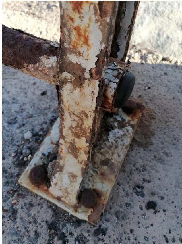
Ilustración 12 Avance de la oxidación en los soportes y barras
