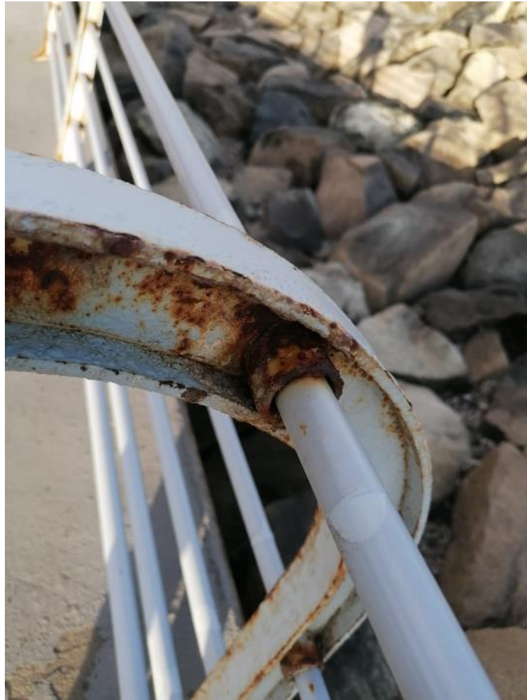
Ilustración 2 Oxidación de los soportes.
