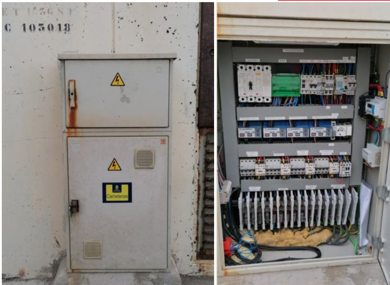
Fig. 4. Cuadro eléctrico del Cabildo de donde se alimentará la UPS del CPD
