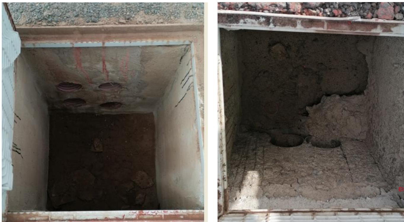
Fig. 3. Arqueta canalización vacante. Izqda. troncal. Dcha. Distribución
