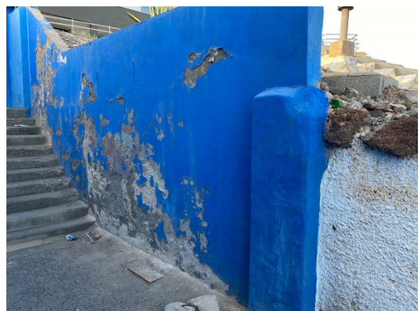
Foto 17. Avanzado desgaste en el muro actual
