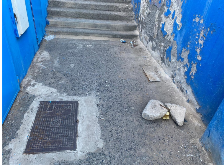
Foto 15. Servicios que se verían afectados
