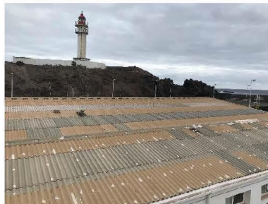
Figura XI: Presencia de placas con amianto en la cubierta
