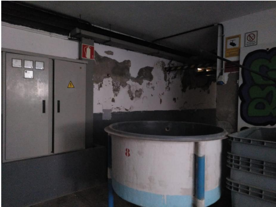
Ilustración 8. Cuadro Eléctrico, planta baja
