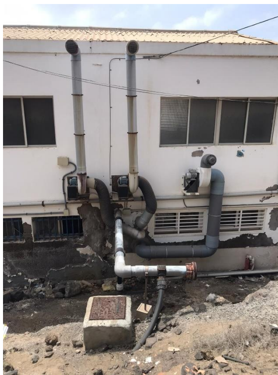
Ilustración 3. Extractores nave colindante, servicios afectados, situación actual
