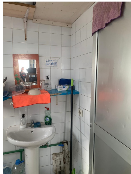
Aseo con instalaciones vistas.
