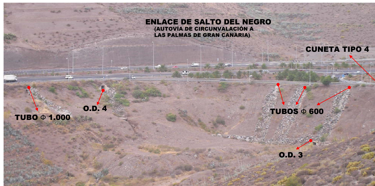
Figura 3. Vista de las obras de drenaje del enlace de Salto del Negro.
