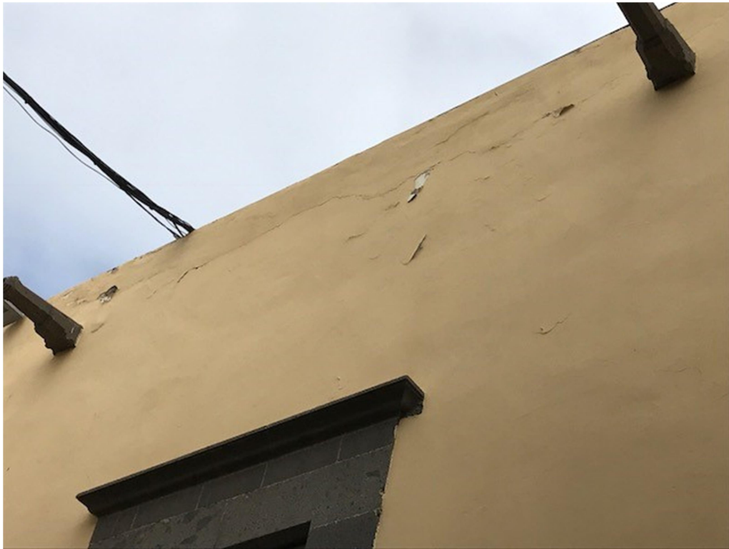
02.- Imagen de Zona Afectada por filtraciones
