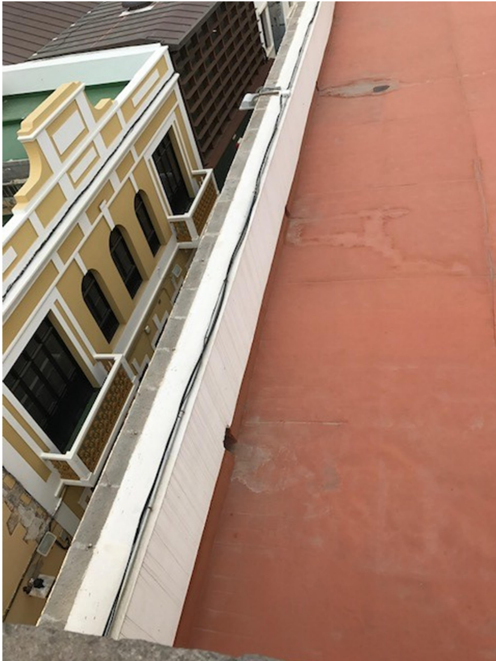
01.- El agua se cuela por las juntas de Pretil y de Gárgolas de cubierta
