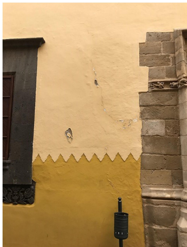
03.- Las Humedades se cuelan por la cantería y aparecen en fachada
