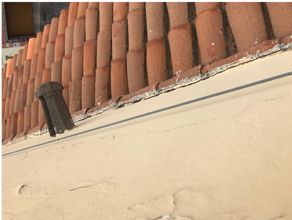
01.- Estado de fisuración de fachada sobre cubierta
