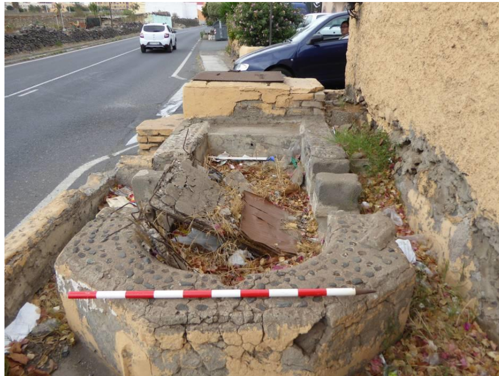
ETN-004: Vista general de la cantonera. La observación de su estado interior nos hace deducir que se encuentra en estado de desuso
