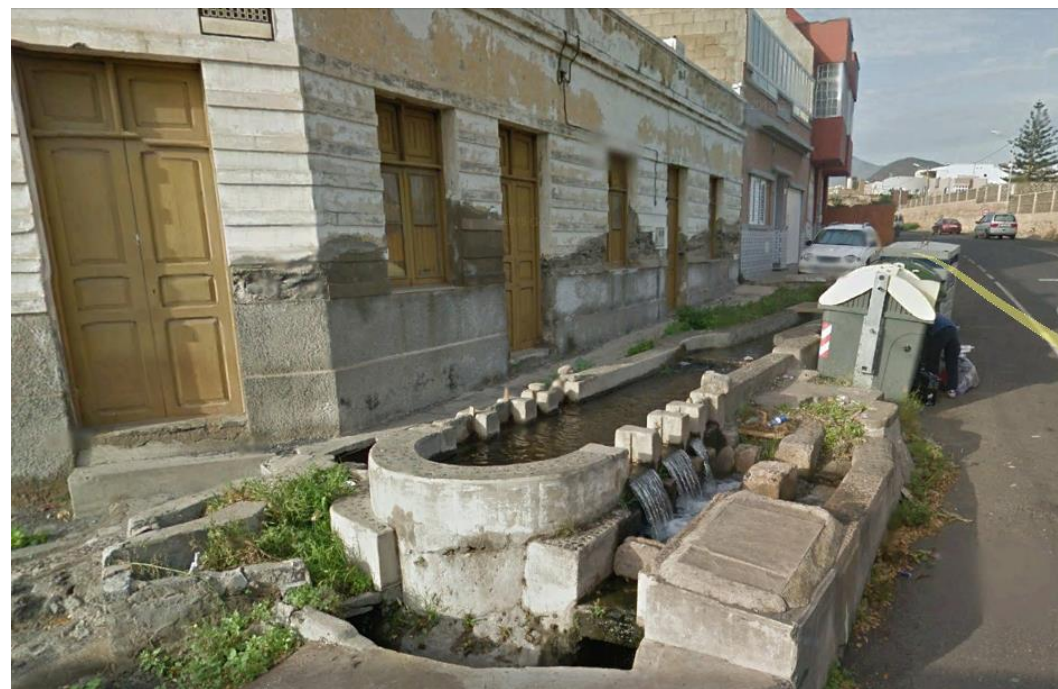
ETN-006: Imagen que data de algunos años atrás en la que se puede apreciar el estado previo de la cantonera antes de que se le añadiesen los tubos de PVC en las troneras
